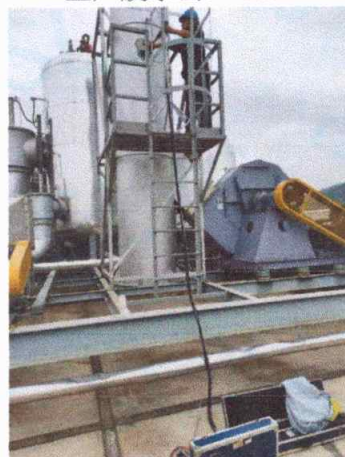
车间二排气筒出口 03#
