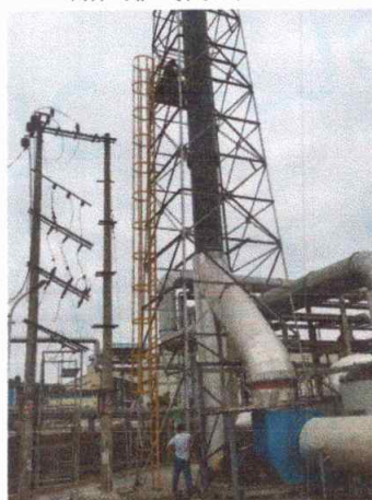
RTO 排气筒出口 06#
