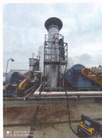
车间一排气筒出口 02#
