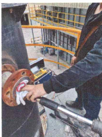
锅炉排气筒出口 01#
