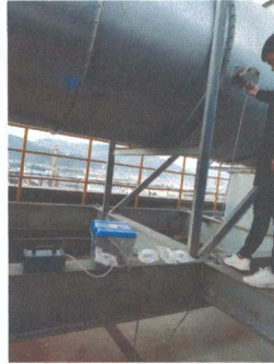
研究室排气筒出口 04#
